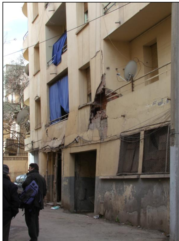
Fig. 9. La ville de Constantine. Des constructions affectées par des glissements de terrain (photo du janvier 2009)
